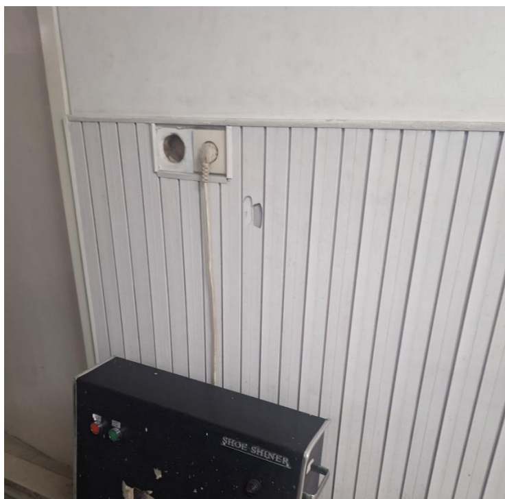
دیوار پوش و پریز معیوب
