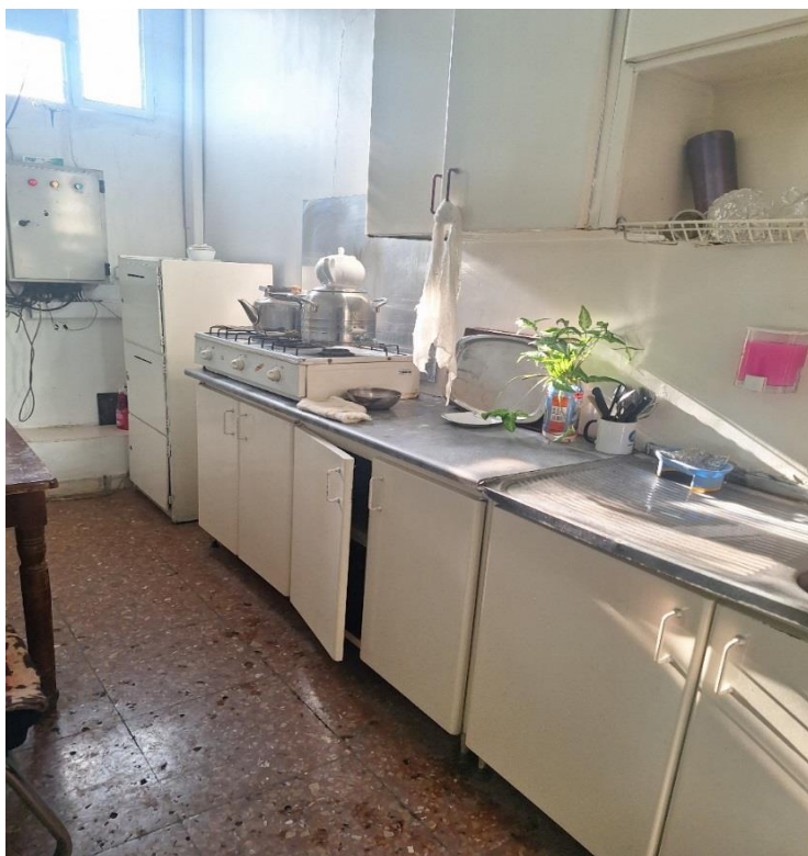
کابینت، سینک فرسوده و کف پوش نامناسب در آبدارخانه
