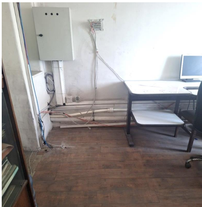
عدم نصب داکت و ساماندهی سیم‌ها
